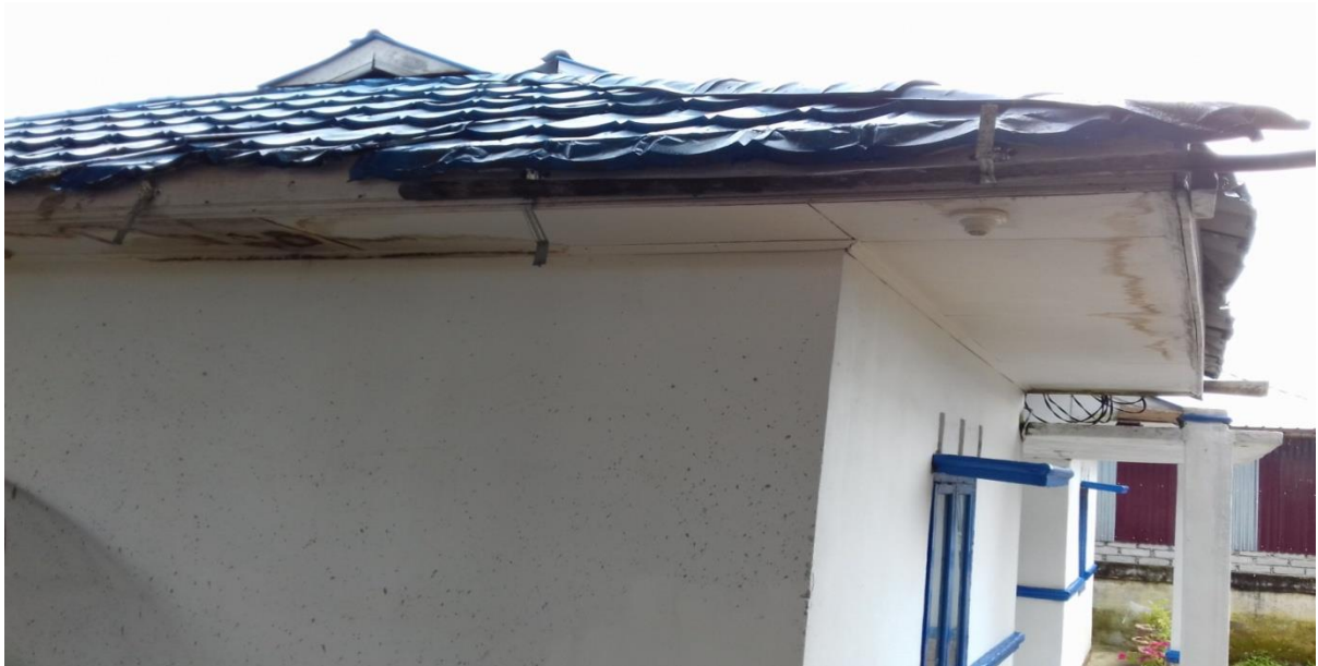
SUASANA KANTOR TERKINI YANG RUSAK AKIBAT PEMBANGUNAN KANTOR CAMAT KECAMATAN HAMPARAN RAWANG
